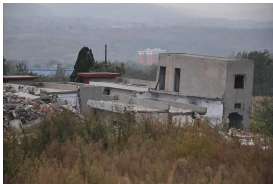
照片 3-2 损毁房屋 1
