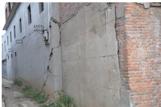
照片 3-5 建筑物裂缝
