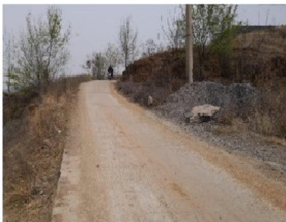
照片 3-2-1 塌陷损毁道路
